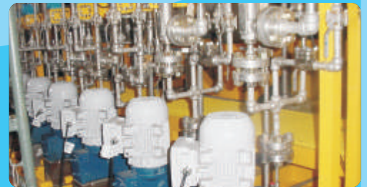
Unidade de Injeção de Produtos Químicos. 10 bombas e motores.
