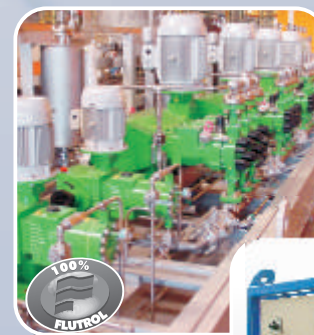
Unidade de Injeção de Produtos Químicos destinada à Plataforma P51 da Petrobras
